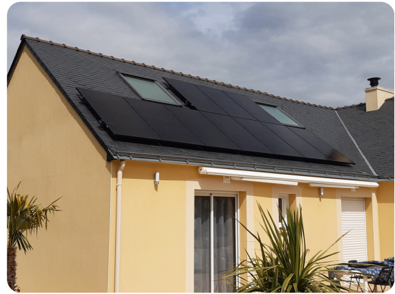
Maison de 4 habitants à Carquefou → 6,75 kWc
